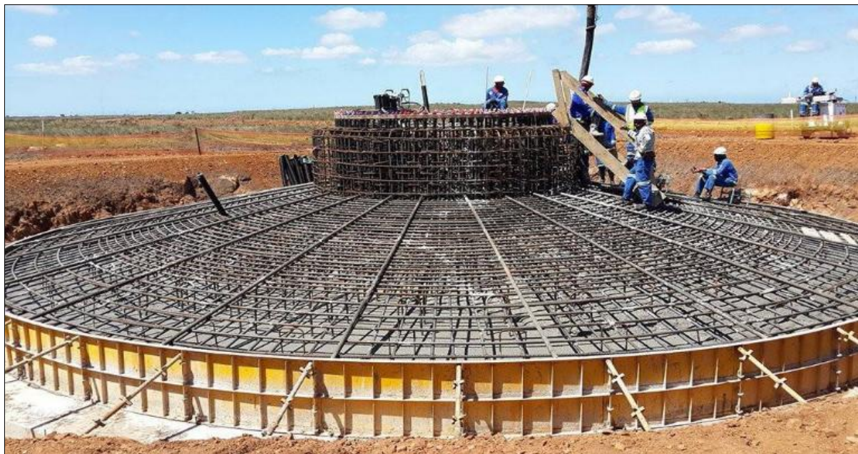
4. sz. ábra A széltorony alapozás különleges biztonsági feladat
